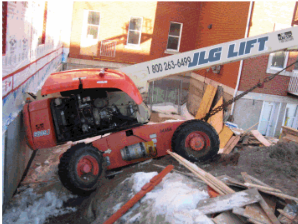
Photographie 1: Nacelle à flèche télescopique lors de l'accident
