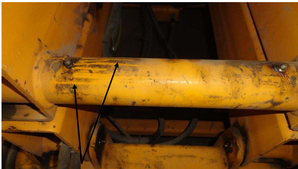
Photo 5 Traces laissées sur la structure de la plate-forme élévatrice par l'utilisation du sommier (Source : CSST)
